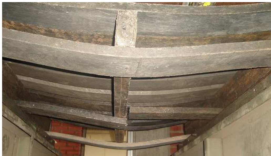
Figura A6c. Ruptura por flexión, lado de 1.000 mm.
