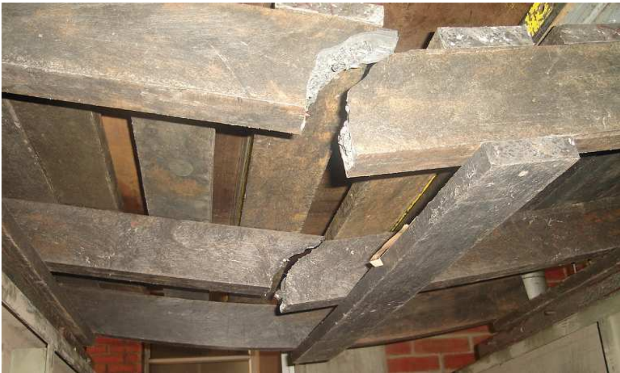
Figura A3b. Ruptura por flexión, lado de 1.200 mm.
