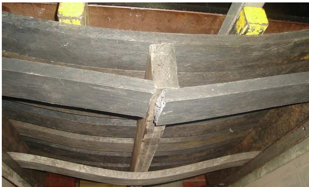
Figura A6a. Ruptura por flexión, lado de 1.000 mm.
